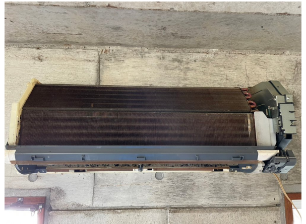
17.エアコンクリーニング
