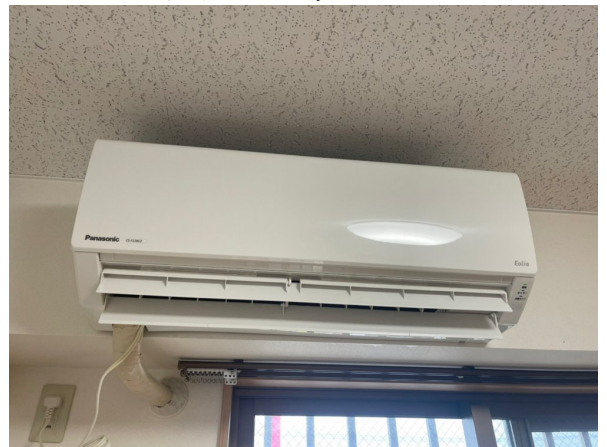
16.エアコンクリーニング
