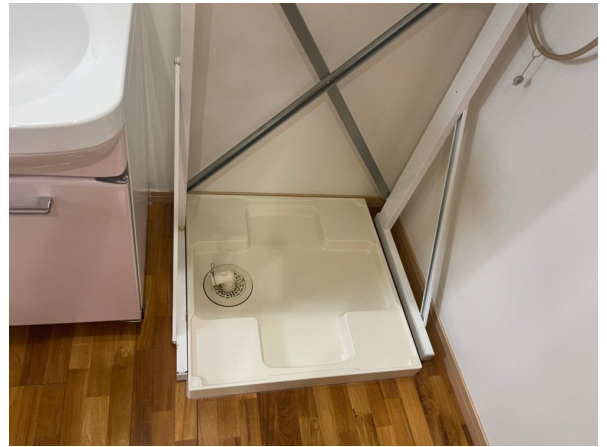
8.洗濯機防水パン
