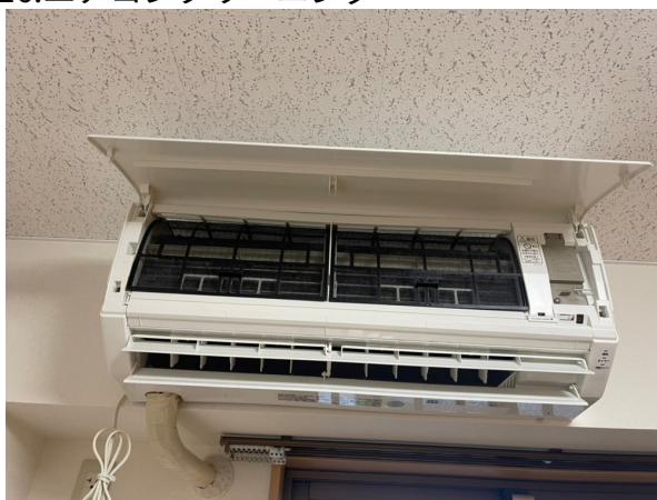
16.エアコンクリーニング
