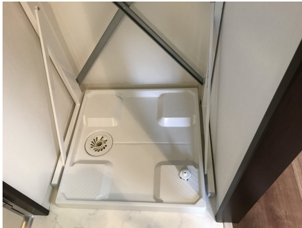
6.洗濯機防水パン
