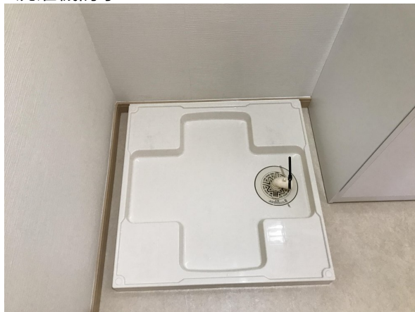
6.洗濯機防水パン
