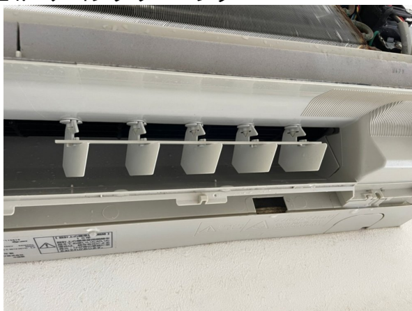
14.エアコンクリーニング
