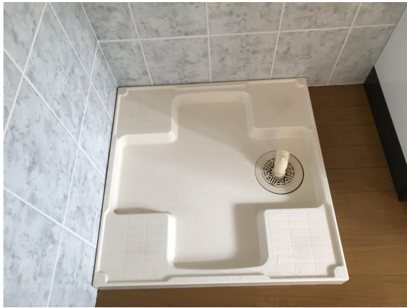
5.洗濯機防水パン
