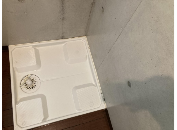
7.洗濯機防水パン
