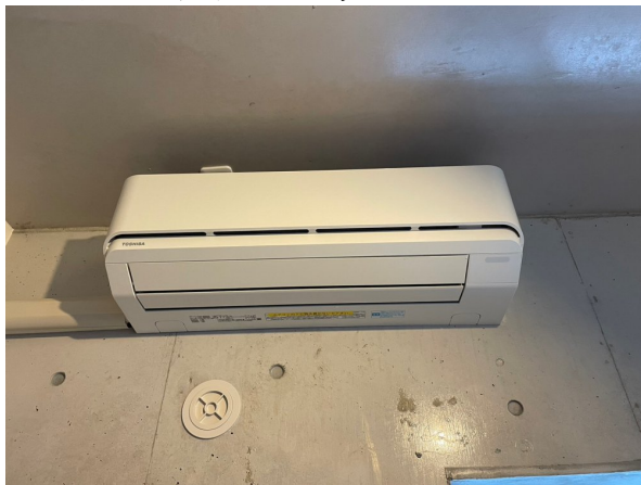
14.エアコンクリーニング
