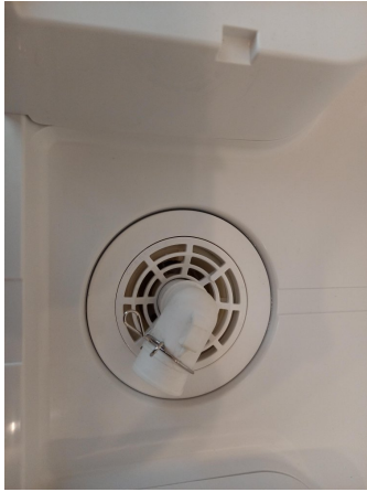
7.洗濯機防水パン
