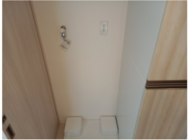
7.洗濯機防水パン
