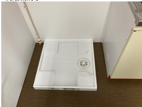
4.洗濯機防水パン
