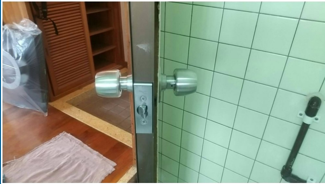
浴室ドア 板浮いてます
