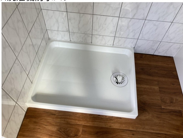
7.洗濯機防水パン
