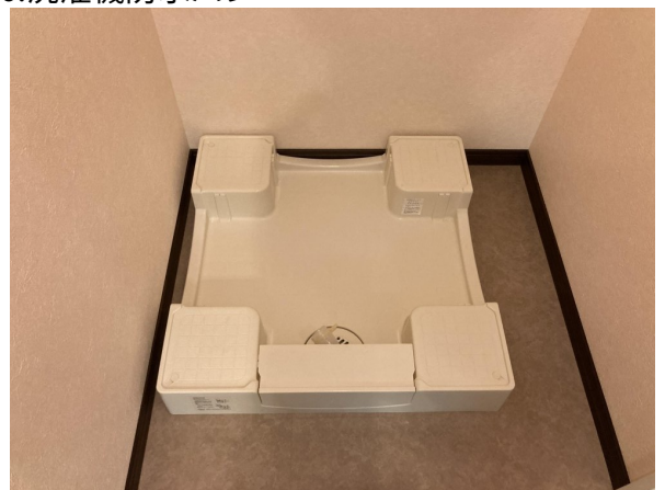
6.洗濯機防水パン
