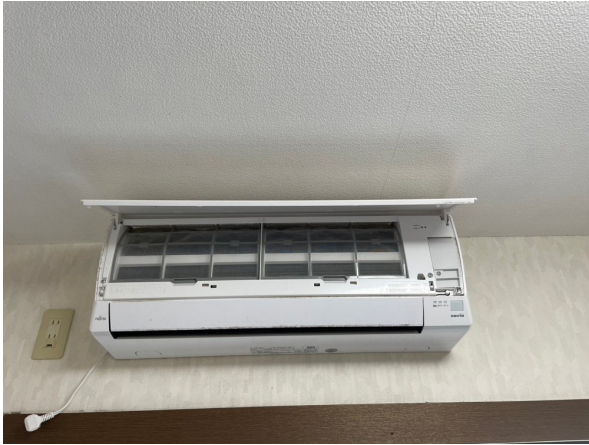
13.エアコンクリーニング
