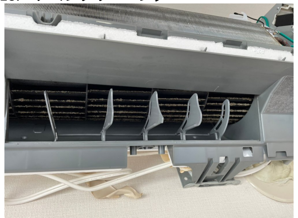
18.エアコンクリーニング
