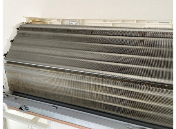
17.エアコンクリーニング
