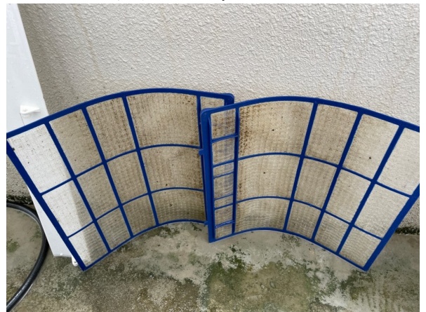
17.エアコンクリーニング
