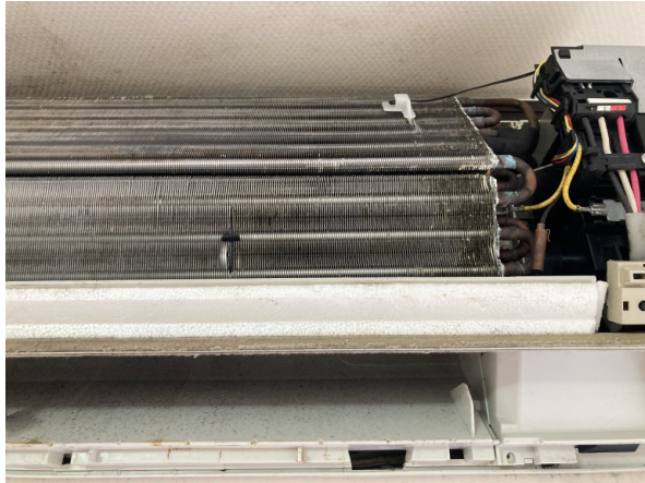
15.エアコンクリーニング
