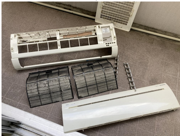
15.エアコンクリーニング
