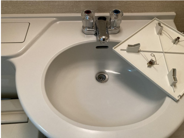
浴室換気扇バネ劣化で折れました。
