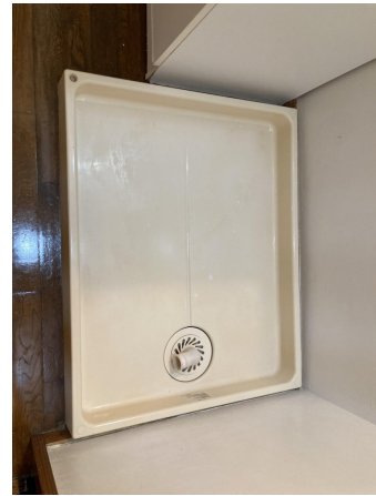
7.洗濯機防水パン
