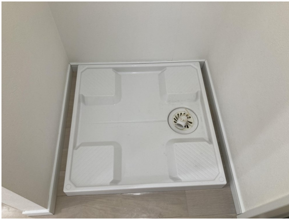
4.洗濯機防水パン
