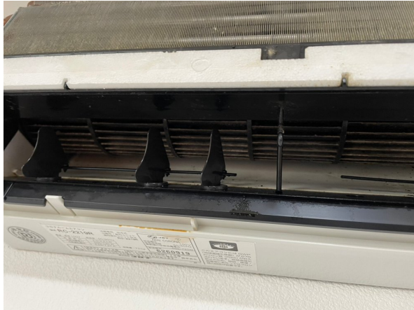
12.エアコンクリーニング
