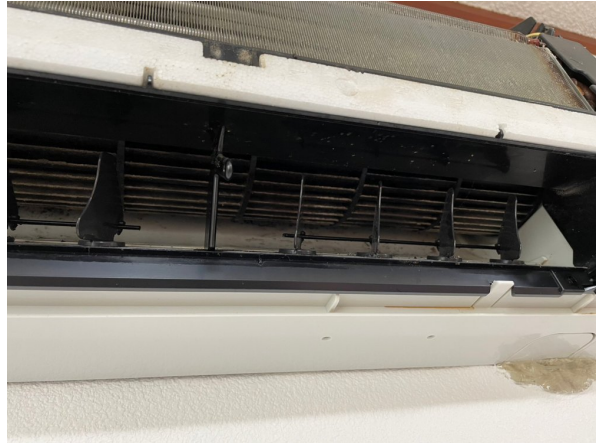
12.エアコンクリーニング
