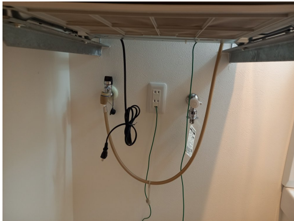
7.洗濯機防水パン
