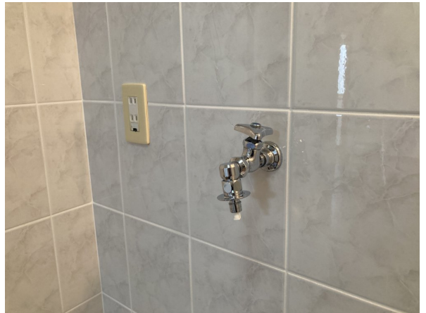
6.洗濯機防水パン
