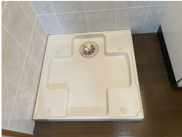
6.洗濯機防水パン
