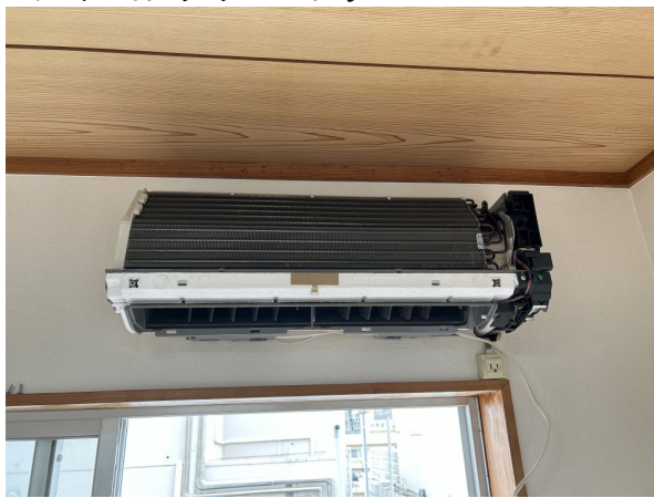
11.エアコンクリーニング
