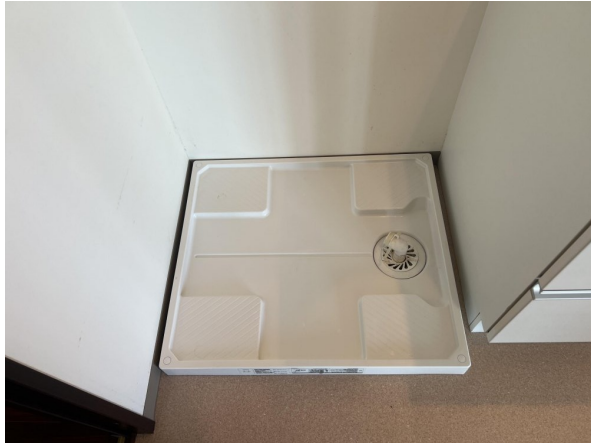
8.洗濯機防水パン
