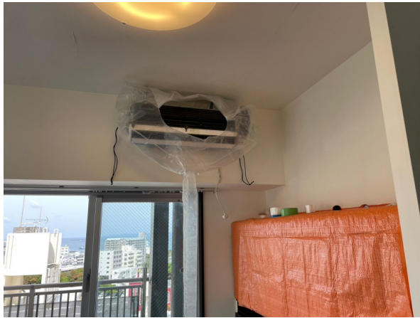
22.エアコンクリーニング
