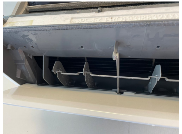
22.エアコンクリーニング
