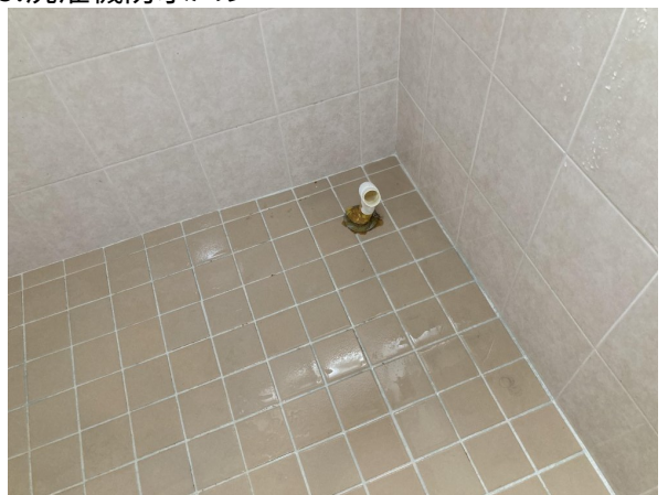
5.洗濯機防水パン
