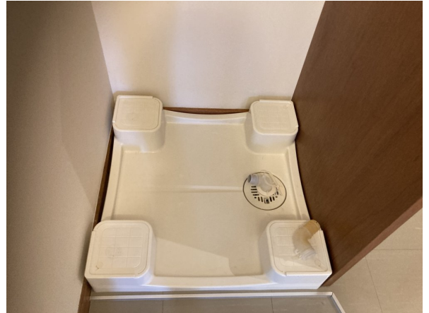
5.洗濯機防水パン
