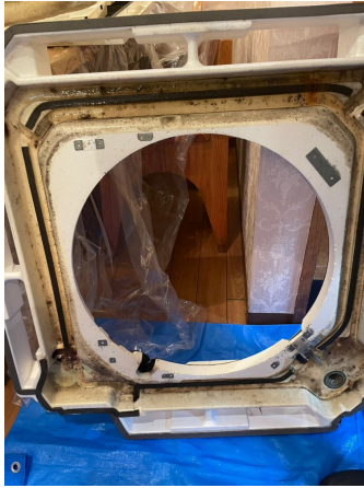
1.エアコンクリーニング
