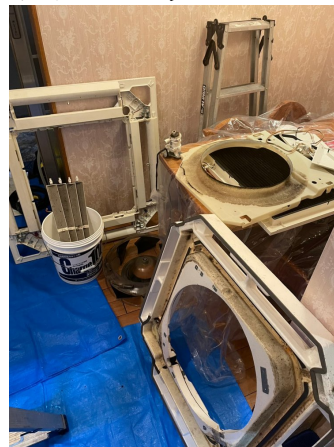
1.エアコンクリーニング
