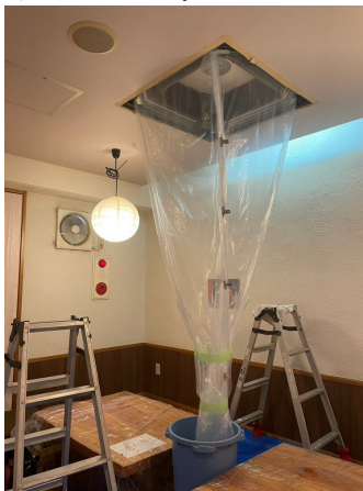
1.エアコンクリーニング
