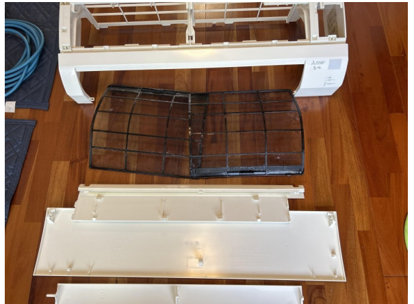
14.エアコンクリーニング
