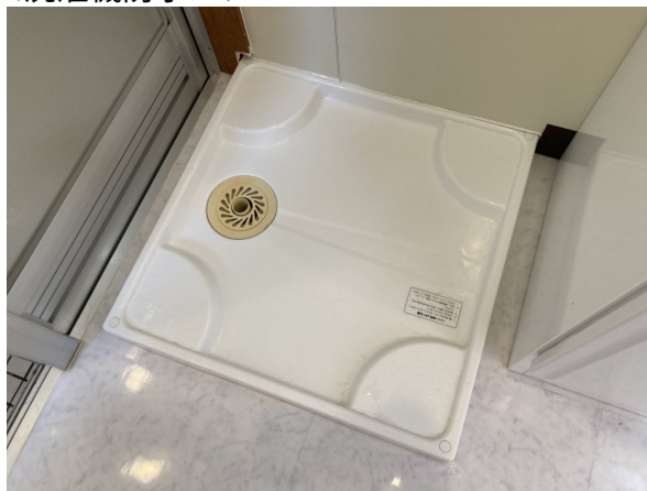
7.洗濯機防水パン
