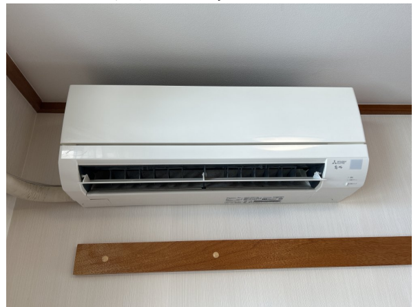
14.エアコンクリーニング
