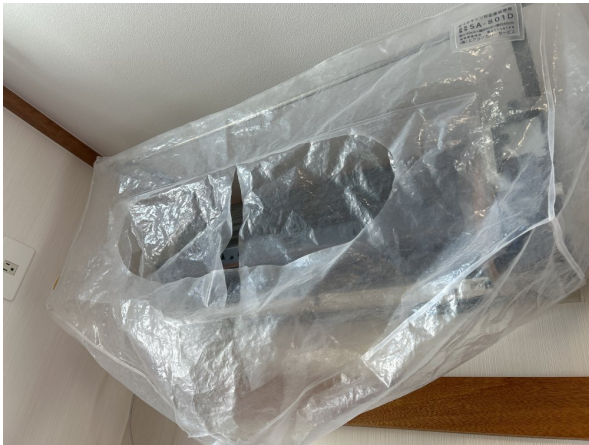
14.エアコンクリーニング
