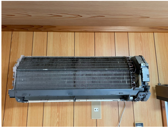
11.エアコンクリーニング
