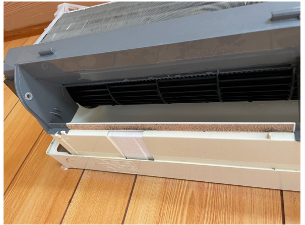
11.エアコンクリーニング
