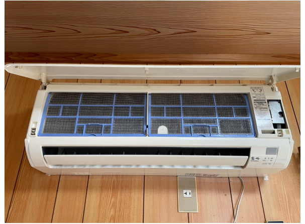
11.エアコンクリーニング
