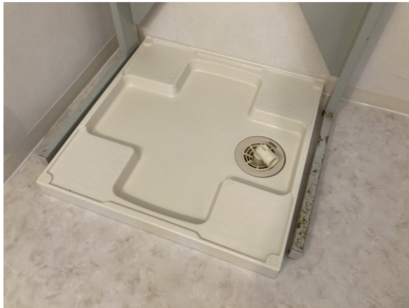
8.洗濯機防水パン
