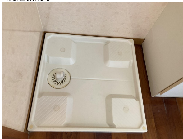
7.洗濯機防水パン
