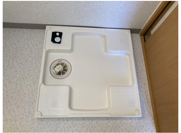
7.洗濯機防水パン
