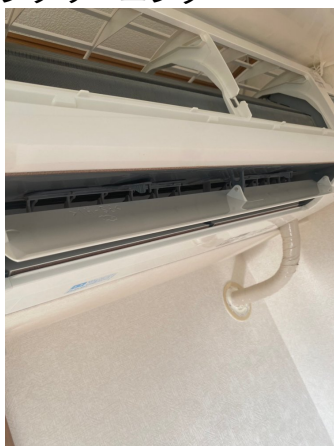
13.エアコンクリーニング
