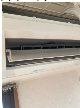
13.エアコンクリーニング
