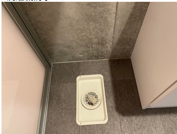
6.洗濯機防水パン
