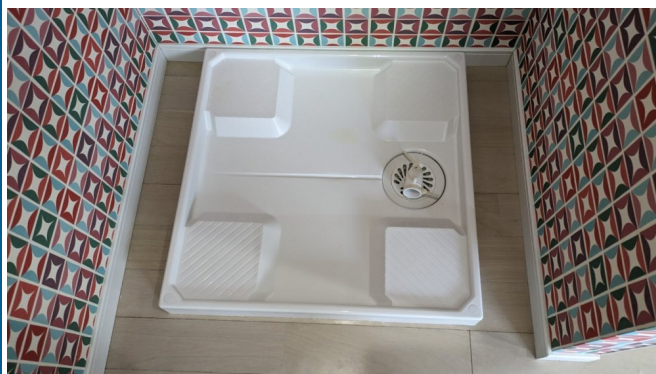
5.洗濯機防水パン
