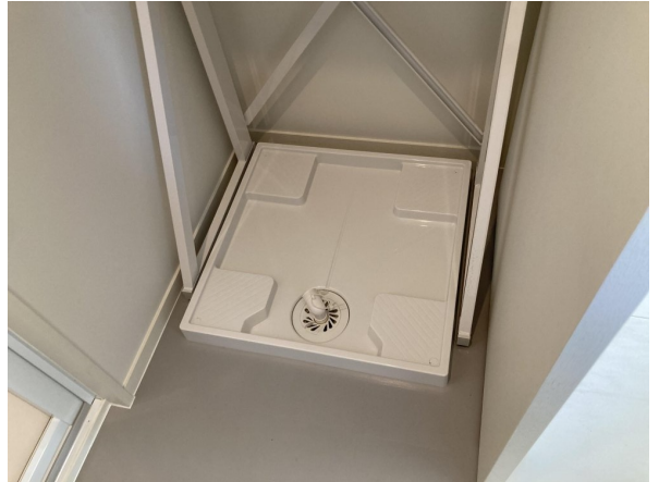
7.洗濯機防水パン
