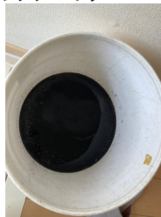
16.エアコンクリーニング
