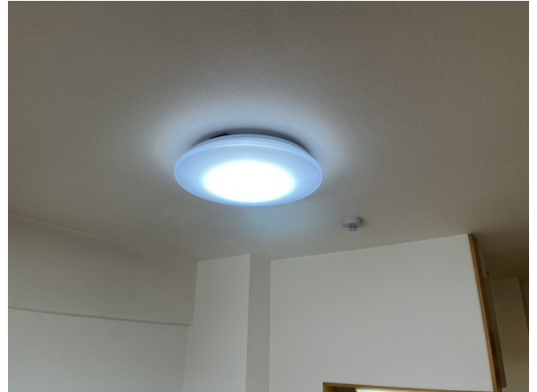
照明取替済み
