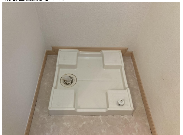
7.洗濯機防水パン
