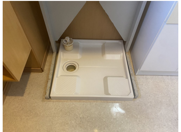
7.洗濯機防水パン
