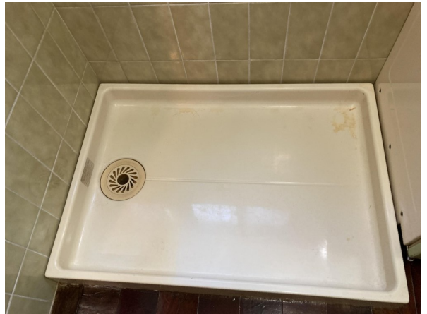
7.洗濯機防水パン
