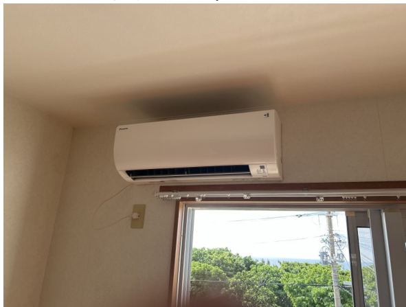
13.エアコンクリーニング
