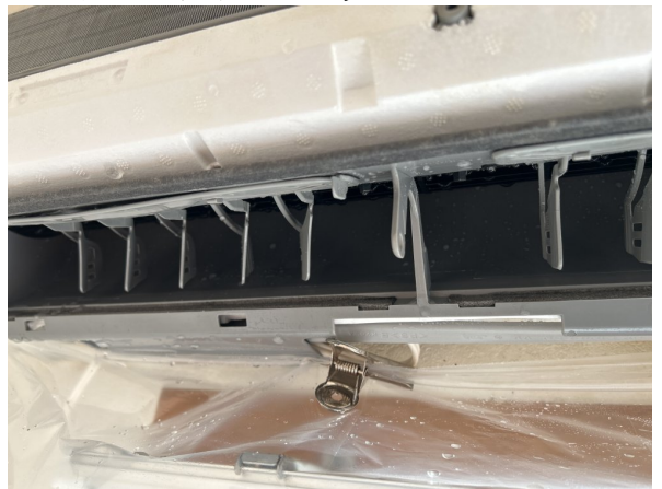
13.エアコンクリーニング
