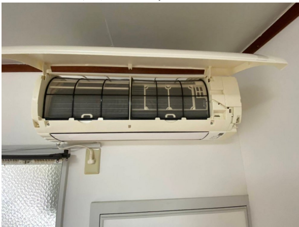
12.エアコンクリーニング
