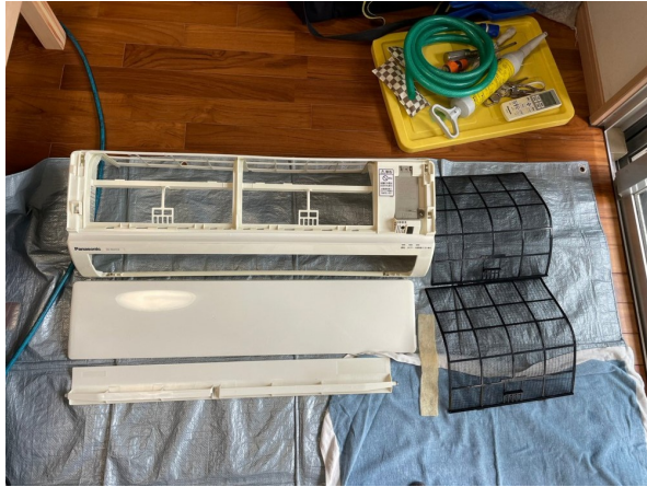
16.エアコンクリーニング
