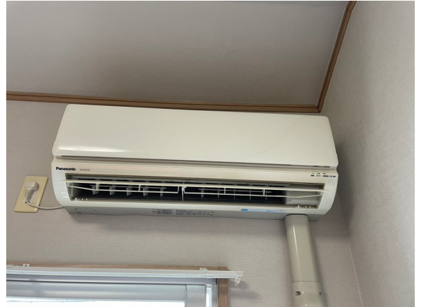
16.エアコンクリーニング
