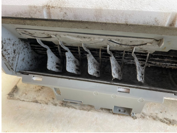
16.エアコンクリーニング
