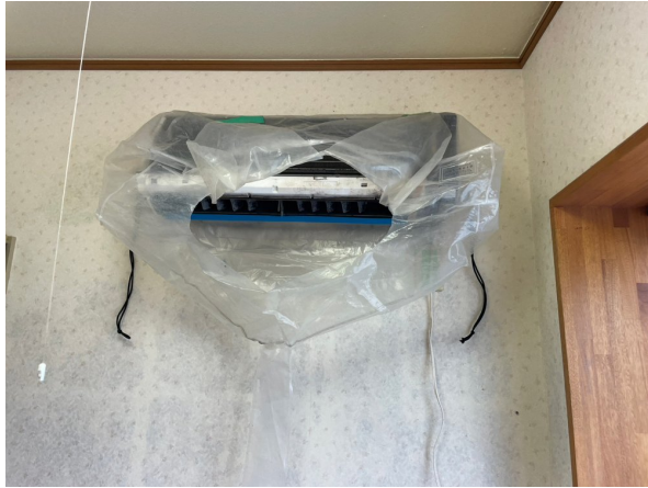
16.エアコンクリーニング
