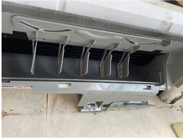
16.エアコンクリーニング
