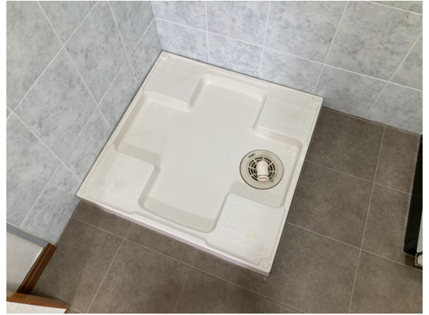
7.洗濯機防水パン
