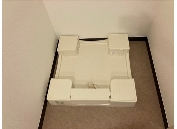
7.洗濯機防水パン
