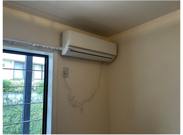
15.エアコンクリーニング
