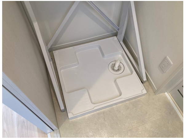
8.洗濯機防水パン
