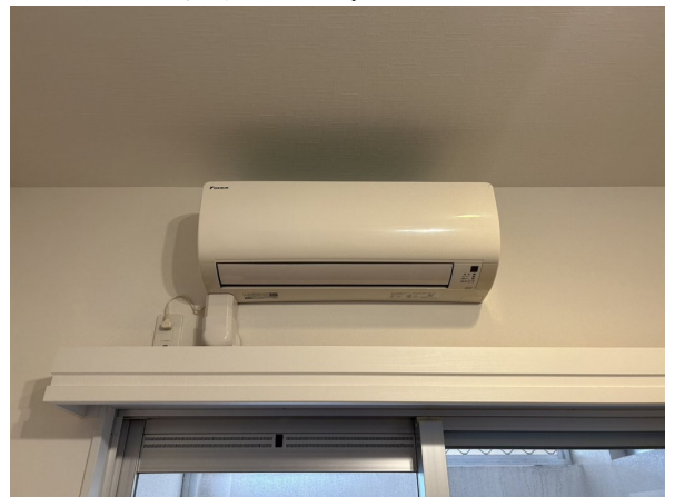
エアコンクリーニング1台
