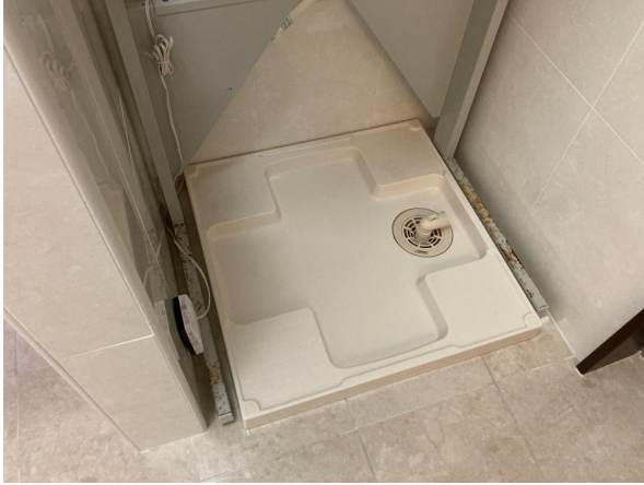
8.洗濯機防水パン
