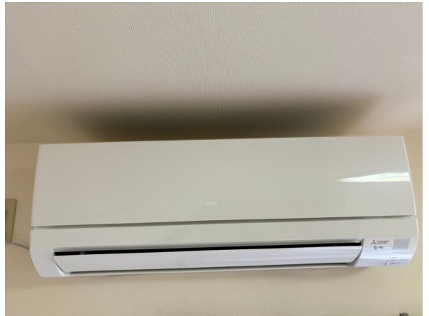
16.エアコンクリーニング
