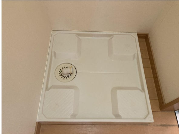
7.洗濯機防水パン
