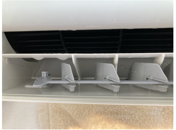
18.エアコンクリーニング
