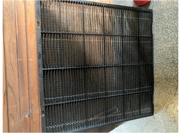
4.エアコンクリーニング
